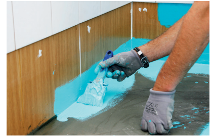
6. Vedeneriste nostetaan seinäpinnalle n. 100 mm, kuitenkin niin, että vedeneristys ja Kiilto Nurkkavahvikenauha nousevat vähintään 30 mm peltikasetin reunan yli.
