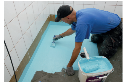
12. Kiilto Kerafiber Vedeneriste telataan kauttaaltaan yli koko lattiapinnan. Ensimmäisen telauksen annetaan kuivua vähintään 2 h (värimuutos). Toisen levityksen jälkeen odotetaan väh. 6 h (värimuutos) ennen laatoitusta. Vedeneristeen kuivakalvonpaksuus lattiassa väh. 0,5 mm.
