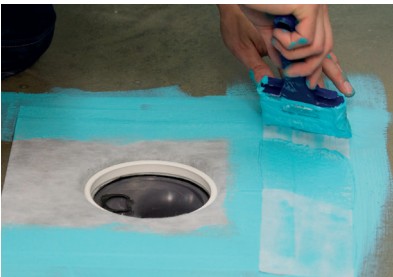
10. Kaivolaipan kahdella sivulla on vahvikankaat, jotka siveillään vedeneristeellä. Vahvikkeettomille reunoille asennetaan erilliset vahvikenauhat, vähintään 30 mm laipan päälle.
