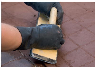
14. Lattiat saumataan Kiilto Lattiasaumalaastilla. Lattiasaumalaasti levitetään kumilastalla painaen saumat täyteen. Ylimääräinen laasti pestään 15-30 min kuluttua.
